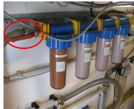
Abb. 4: Wasseranschluss für eine Sprühkühlung (ein selten genutzter Wasserstrang, der bei Nichtnutzung physisch abgekoppelt werden sollte - ein Kugelhahn reicht nicht aus, um rückwärtige Verkeimungen aufzuhalten) ©K. Aumann
