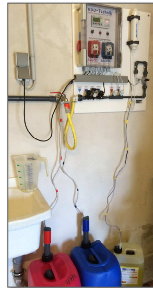
LC Des Abfüll-Anlage
